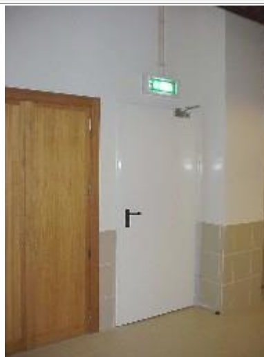
Saída de emergência devidamente assinalada
