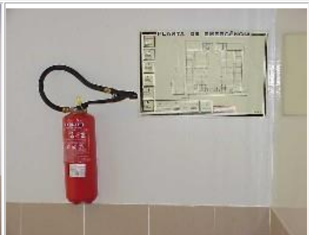
Extintor de Pó ABC de 6 kg
