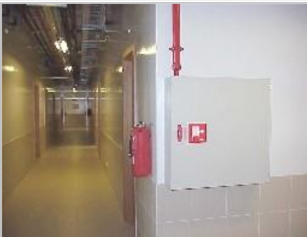
Boca-de-incêndio do "tipo carretel"
